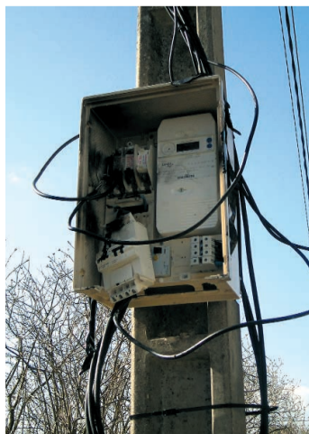
Rue des Carrières. Un branchement sur ce poteau électrique avait entraîné un début d'incendie.
